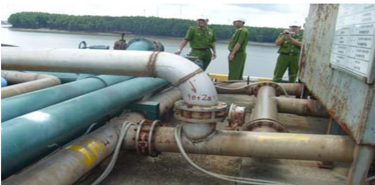
Hệ thống ống chằng chịt, trong đó có nhiều đường ống ngầm xả thẳng nước thải chưa qua xử lý xuống sông Thị Vải từ Công ty Vedan.
